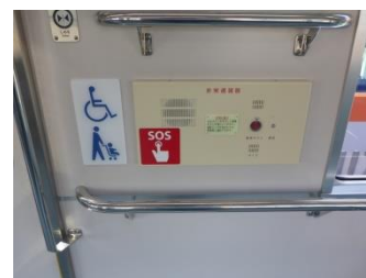
非常通話装置
