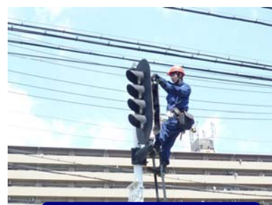
【信号機の定期検査】
