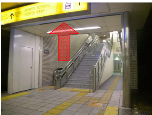
【防火防煙シャッター】
