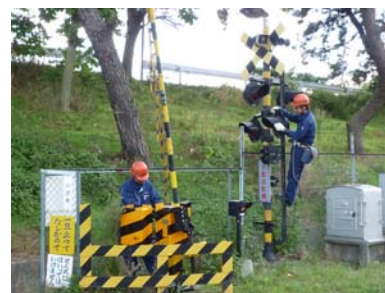
【踏切保安装置の定期検査】
